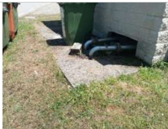
Foto 17. Detalle tuberías de impulsión
