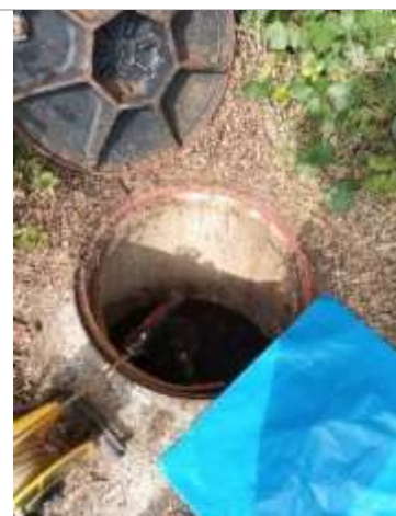
Foto 11. Medición de nivel en pozo.
