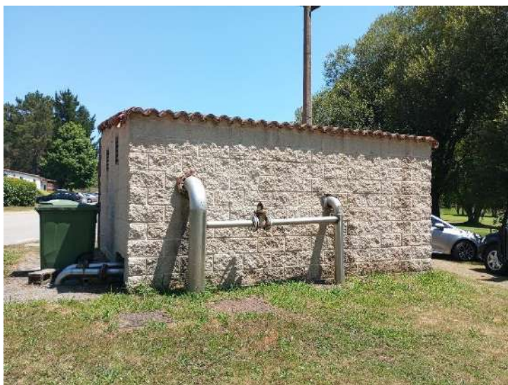
Imagen 5. Estación bombeo campo de golf.
