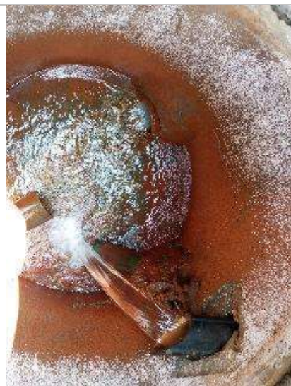
Foto 21. Detalle arqueta colectora.
