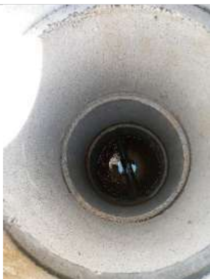
Foto 22. Detalle pozo filtrante del manantial de Bidueira.
